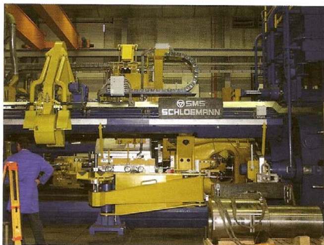
Gesamtanlage (Foto: METALL)
