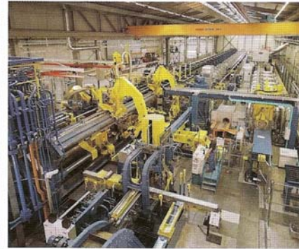
Gesamtansicht der Pressenanlage (Foto: SMS)
